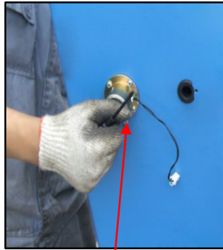
Elektromagnet an der Außenfläche der Säule
